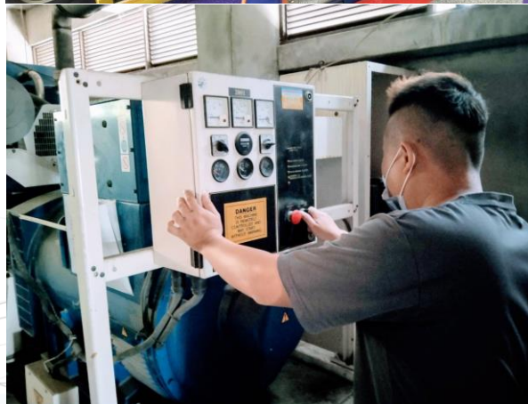
☞發電機、避雷設備公共設施定期檢測，以確保緊急狀況時可正常供電使用；每月試車乙次，每次15分鐘。
