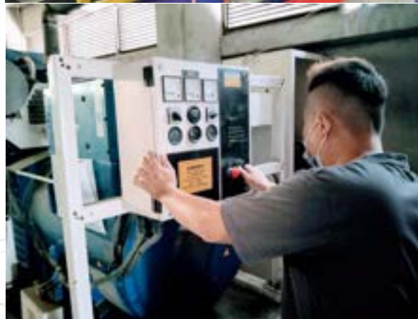
☞發電機、避雷設備公共設施定期檢測，以確保緊急狀況時可正常供電使用；每月試車乙次，每次15分鐘。
